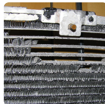
Meerdere rijen ontbrekende lamellen veroorzaakt door corrosie
