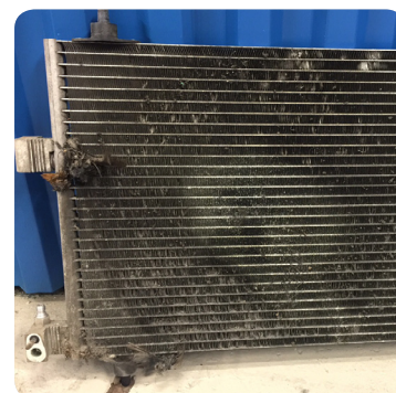
Lijkt niet lek echter verkeert de condenser in zo'n toestand dat deze niet goed meer werkt en moet worden vervangen
