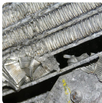
Lekkage veroorzaakt door ontbrekende lamellen
